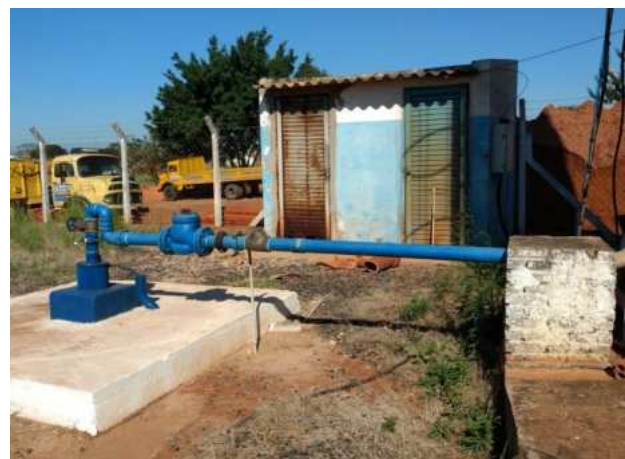
Foto 6.12 - Identificação do Poço: P15
