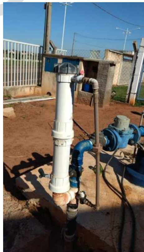
Foto 6.24 – Desinfecção no poço através de dosador automático de Flúor e Cloro
