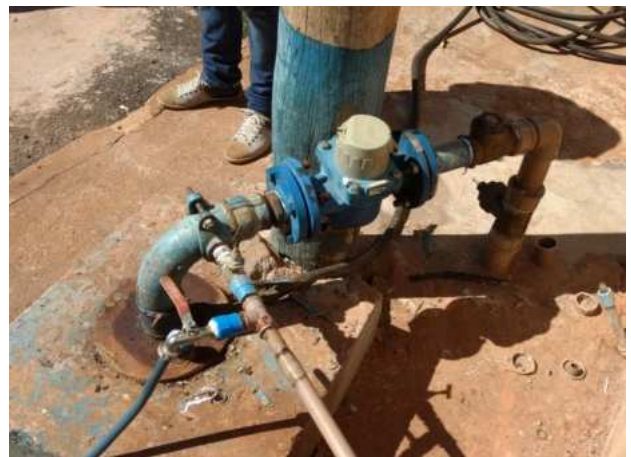
Foto 6.6 - Identificação do Poço: P08
