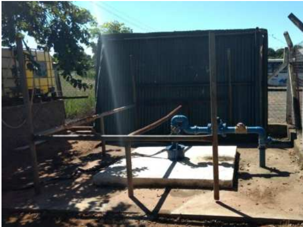
Foto 6.13 - Identificação do Poço: P16
