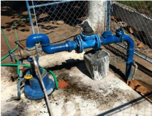
Foto 6.1 - Identificação do Poço: P01
