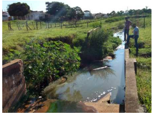
Foto 6.52 – Escada hidráulica – Vista do desmoronamento
