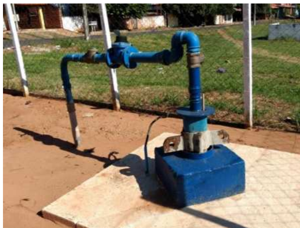
Foto 6.9 - Identificação do Poço: P12
