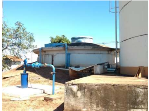
Foto 6.2 - Identificação do Poço: P02
