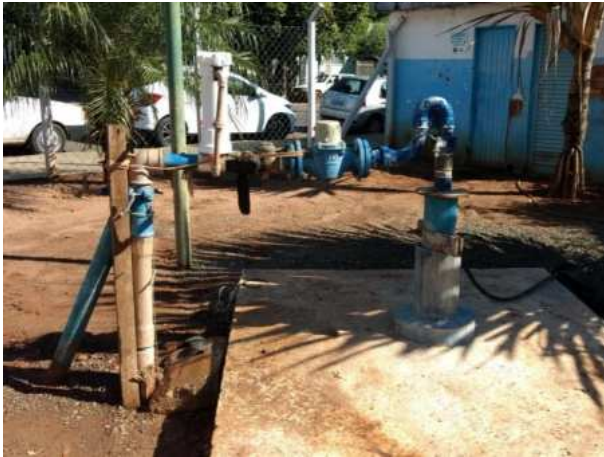
Foto 6.7 - Identificação do Poço: P10
