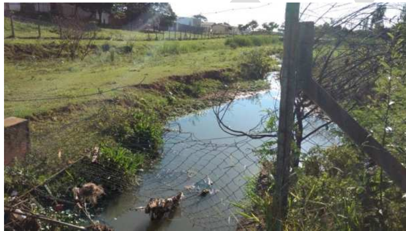
Foto 6.53 – Fim da escada hidráulica – reservatório de retenção
