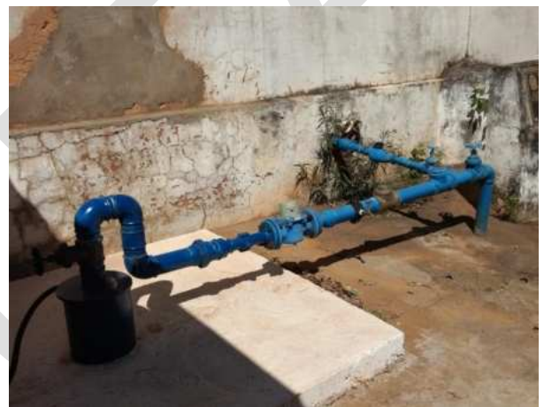
Foto 6.4 - Identificação do Poço: P06
