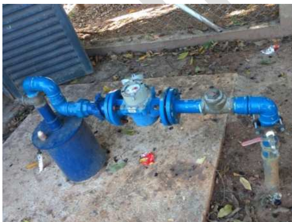
Foto 6.11 - Identificação do Poço: P14
