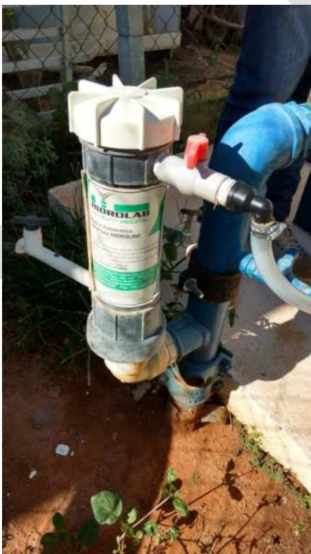
Foto 6.23 – Desinfecção no poço através de dosador automático de Flúor e Cloro
