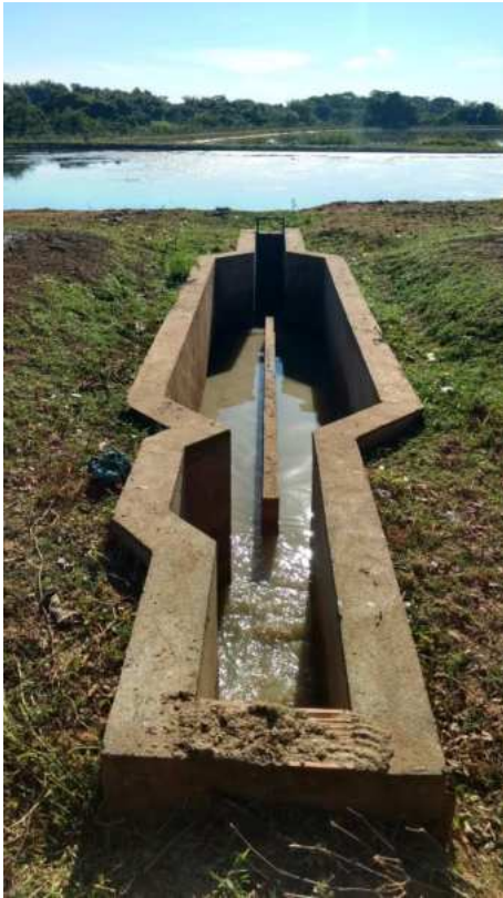
Foto 6.38 - Entrada ETE Pau d'Alho
