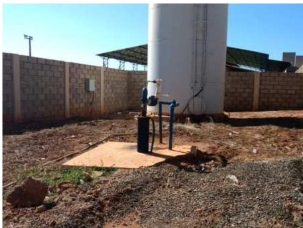
Foto 6.15 - Identificação do Poço: P18
