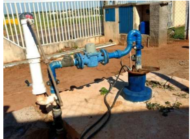
Foto 6.14 - Identificação do Poço: P17
