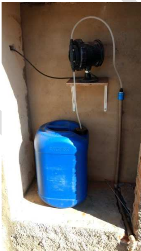
Foto 6.19 – Desinfecção no poço através de bomba dosadora
