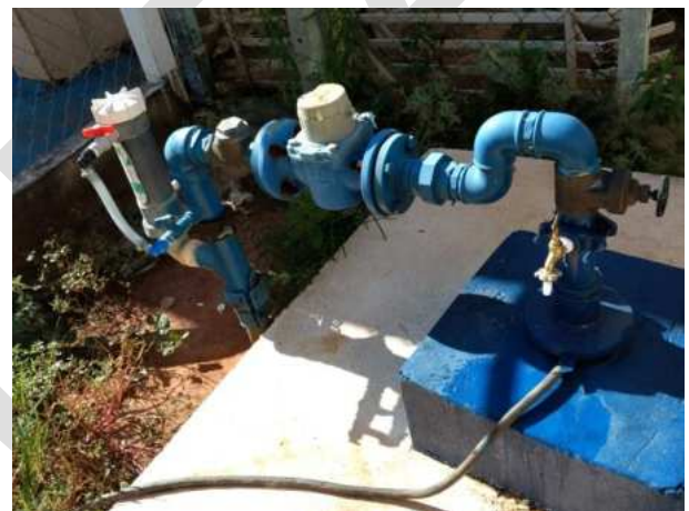
Foto 6.10 - Identificação do Poço: P13
