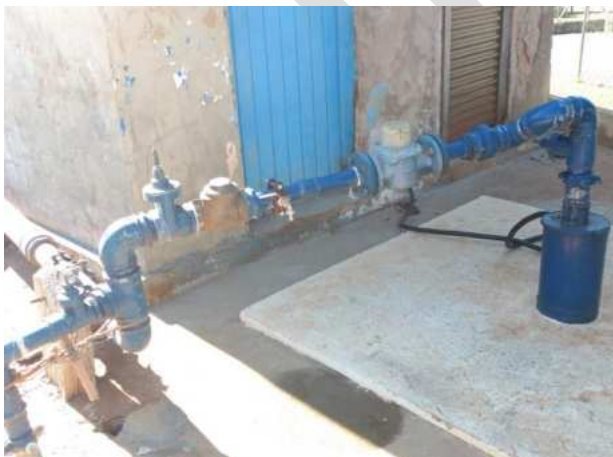
Foto 6.5 - Identificação do Poço: P07
