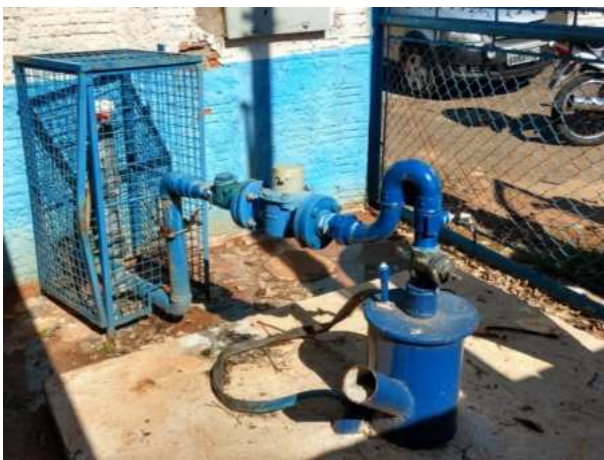
Foto 6.3 - Identificação do Poço: P04
