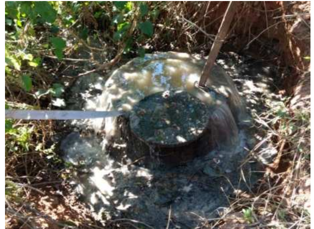
Foto 6.33 – PV transbordando e despejando esgoto na voçoroca
