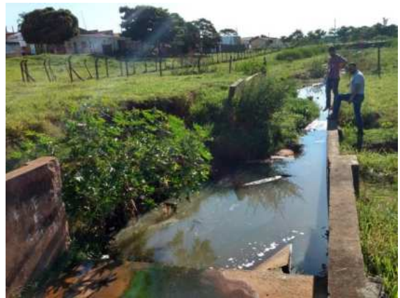
Foto 3.52 – Escada hidráulica – Vista do desmoronamento
