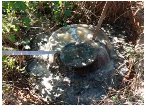
Foto 3.50 – PV transbordando e despejando esgoto na voçoroca
