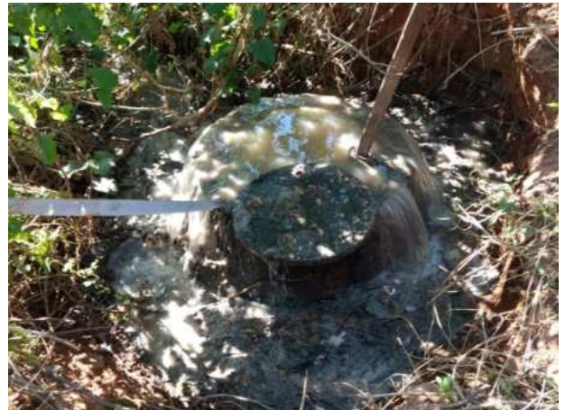
Foto 3.33 – PV transbordando e despejando esgoto na voçoroca
