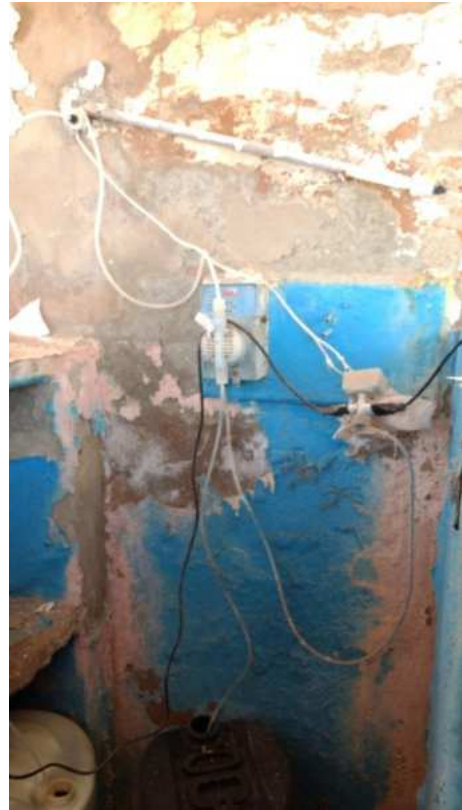
Foto 3.22 – Desinfecção no poço através de bomba dosadora
