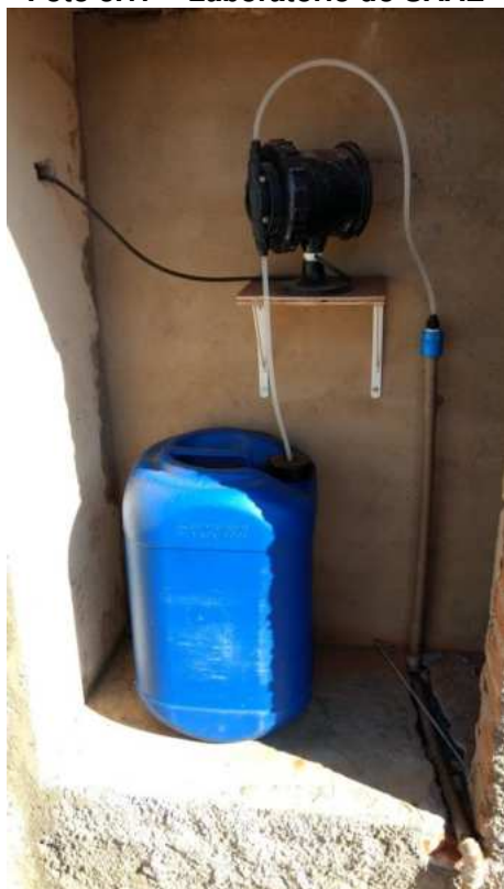
Foto 3.19 – Desinfecção no poço através de bomba dosadora
